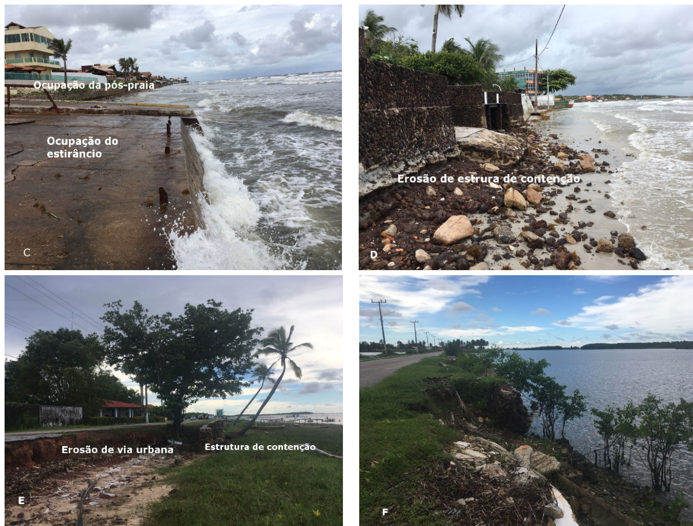
Figura 10: Ação das ondas e correntes longitudinais e de marés sobre estruturas artificiais: (C) Setor da praia do Atalaia, em Muito Alta Vulnerabilidade, sofrendo ataque das ondas; (D) Setor da praia do Farol Velho em Muito Alta vulnerabilidade, apresentando intenso processo erosivo; (E e F) Setor de Falésia Leste, a ação, principalmente das correntes de marés tem provocado erosão nas vias de circulação. Fonte: Fotos de Ronaldo Braga (08/04/2018).
